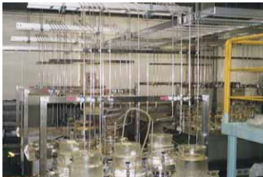
図 3.2-4 高精度ガス発生量評価システムの全景
