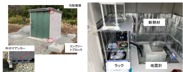
図-6 地震計④の設置状況
