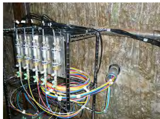
図-9 間隙水圧計設置状況
